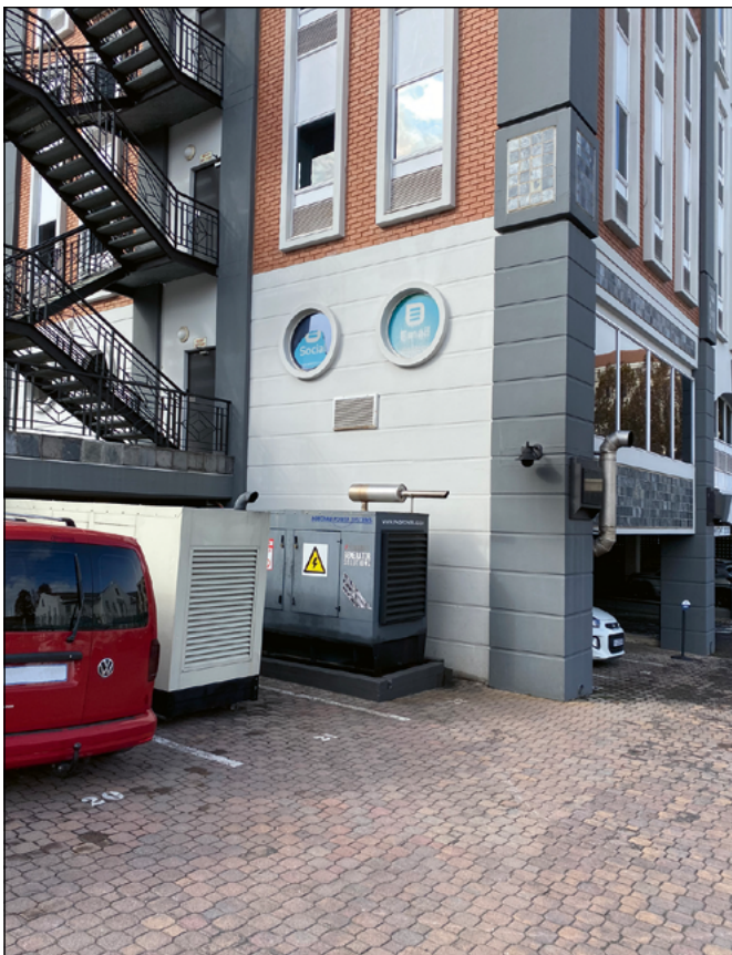
Abbildung 1: Bürokomplex mit Notstromversorgung, Johannesburg, Südafrika
